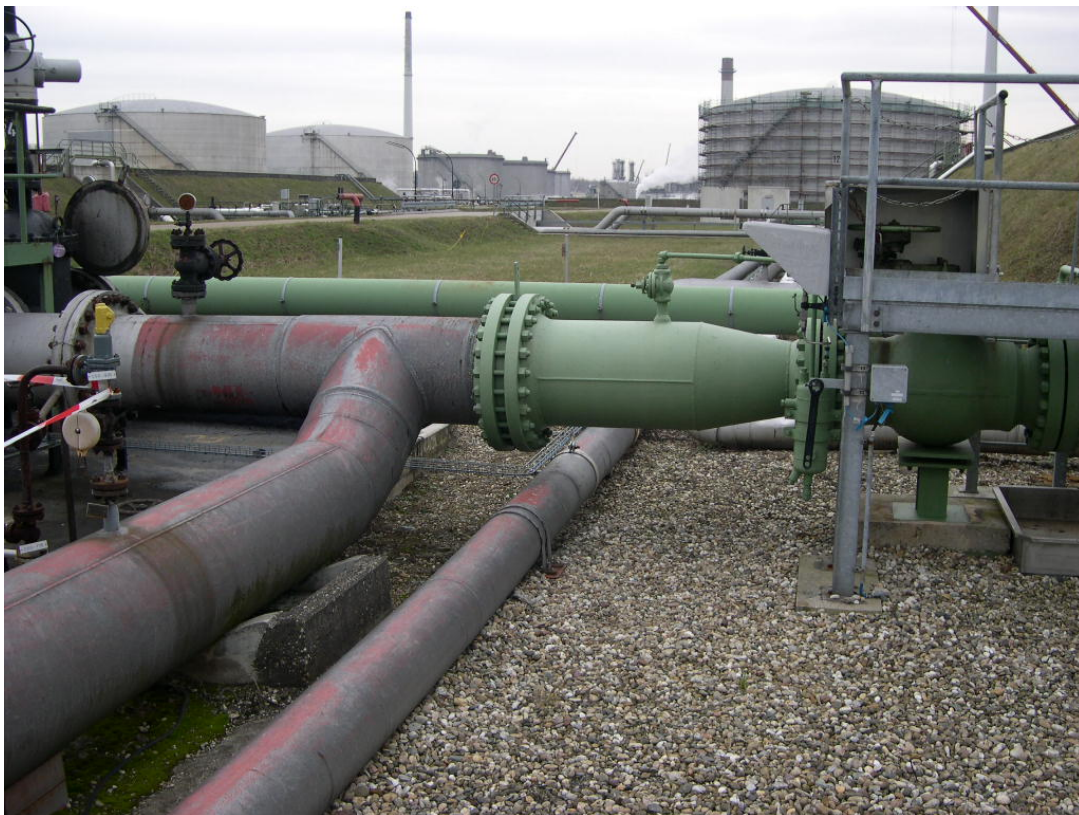
Abb. 6: Flanschverbindung zwischen Rohrfernleitung (grün) und Tanklager als definierte Schnittstelle
